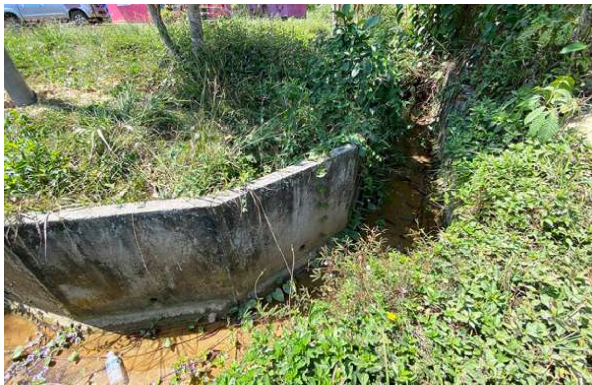
KEADAAN longkang yang rosak dan tidak diselenggara menyebabkan berlaku mendapan.
